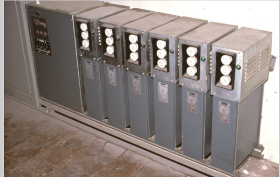
Einzel gesicherte Kondensatorengruppe Standort in jedem Raum möglich. Auffindung möglicherweise schwierig. Beispiel aus lebensmittelverarbeitendem Betrieb.
