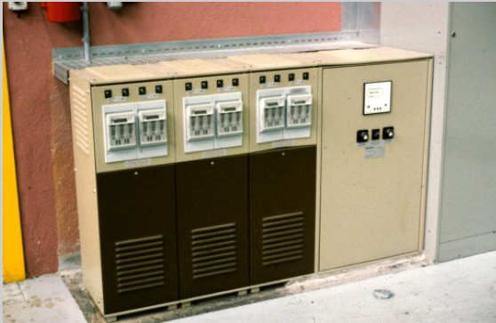
Autonom stehende Kompensationsanlage Standort in jedem Raum möglich.
